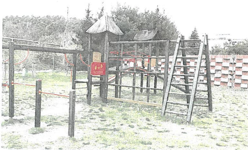
Fot. nr 3. ZESTAW ZABAWOWY: kratownica drewniana - drążek górny i środkowy poziomy do wymiany
