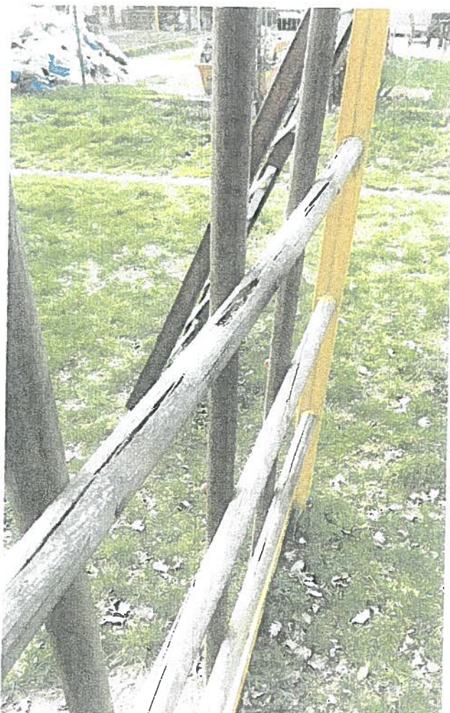
Fot. nr 2. ZESTAW ZABAWOWY: kratownica drewniana - 1x szczebelek górny poziomy do wymiany
