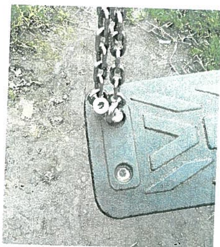
Fot. nr 8. HUŚTAWKA PODWÓJNA: (siedzisko płaskie) uzupełnić mocowanie łańcuszka od siedziska.
